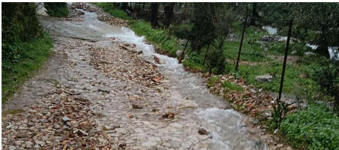
Daños en la calzada romana de Ubrique (Cádiz)Ayuntamiento de Ubrique
