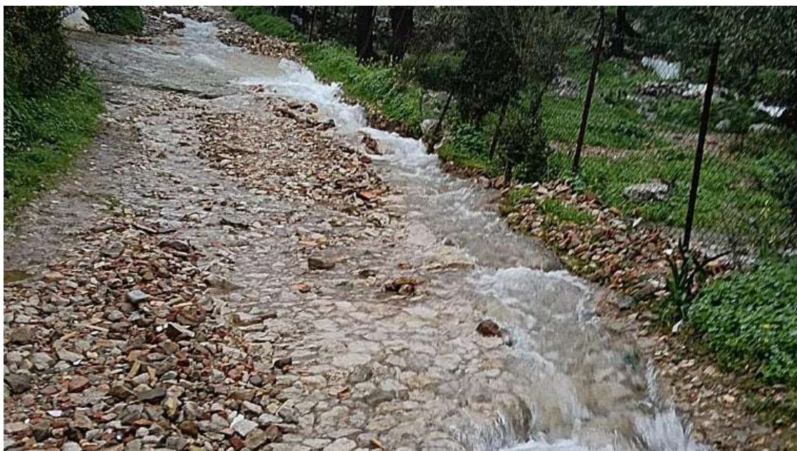
Daños en la calzada romana de Ubrique a Benaocaz. Imágenes de los socavones la voz
