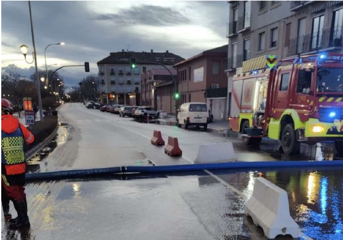
Las bombas aumentan a 28 que sacan 2 millones de litros/hora
