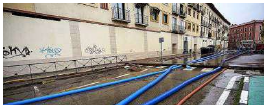
Tuberías por las que se evacua el agua. / MANU REINO
